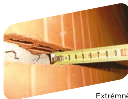
Neúměrně velké kapsy pro instalace
